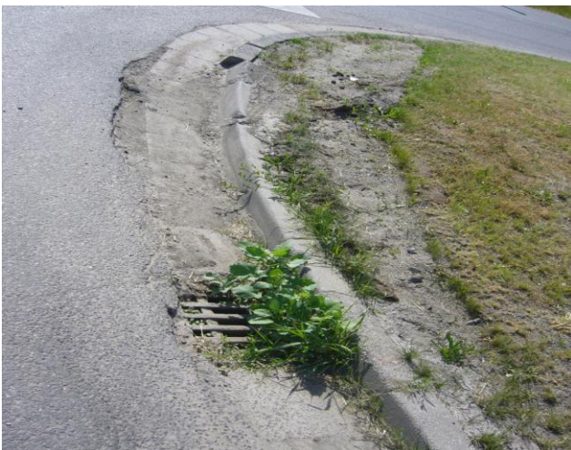
vor der Reparatur
