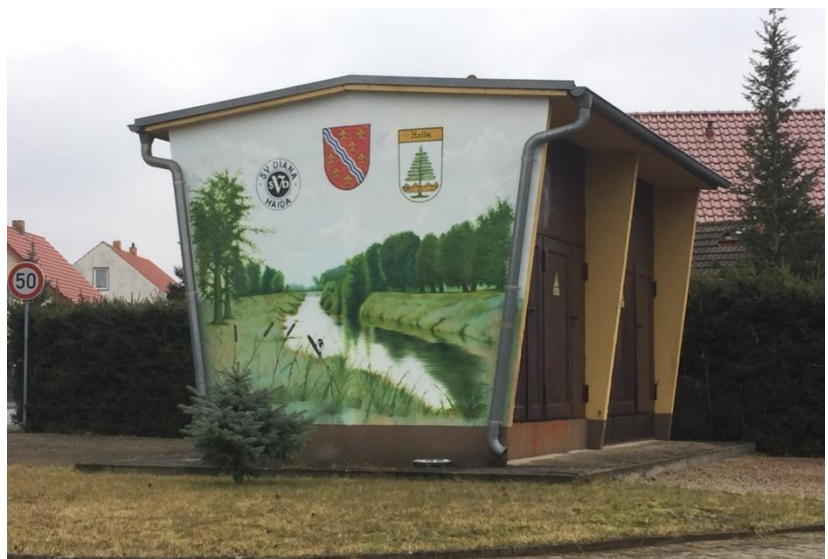
Beispielfoto: Trafohäuschen in Haida
